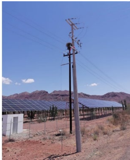
Imagen. Planta de generación fotovoltaica
